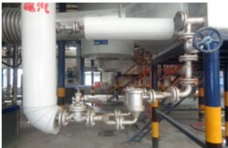
用能设备安装节能疏水器—新工艺密闭干燥加热器
