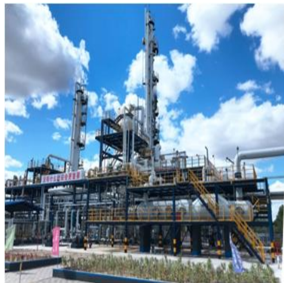
硫磺尾气吸收装置
